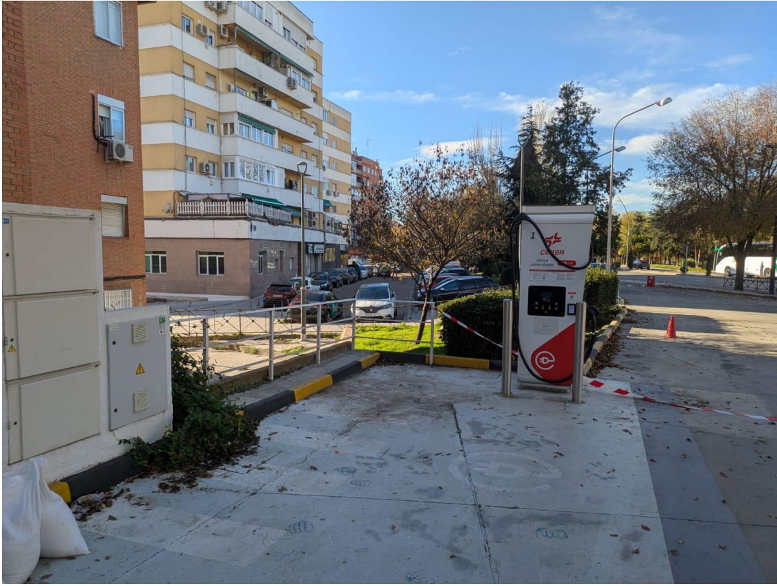
Plaza de carga y cuadro eléctrico
